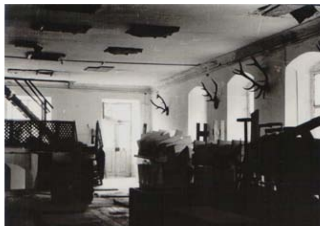
provozní chodba v patře, ve stropě a podlaze zaslepené prostupy po mlecí technologii foto Karel Kopal st.
